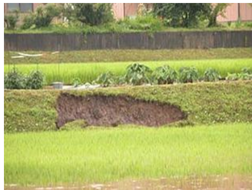
法面の崩壊状況
