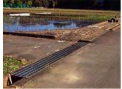
コンクリート蓋とグレーチング
