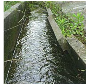
側壁の倒壊（側溝）
