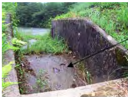
洪水吐底板（コンクリート）の欠損
