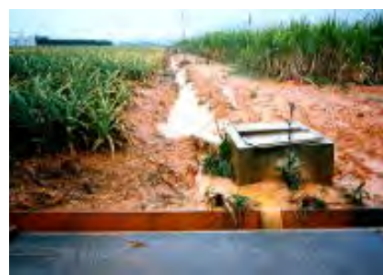
土砂の流出状況
