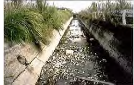
水量が減少した水路
