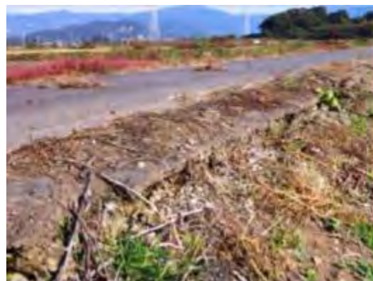
路肩の浸食と路面下の空洞
