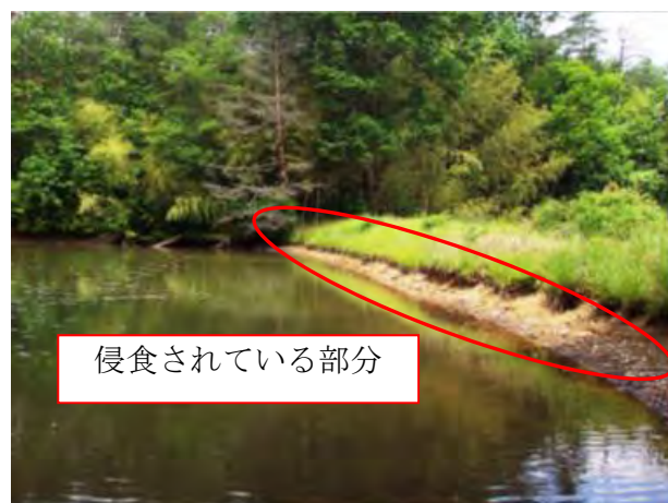
侵食が生じているため池堤体
