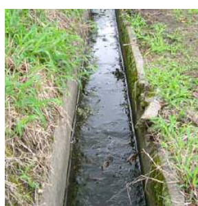
部分的な欠損
