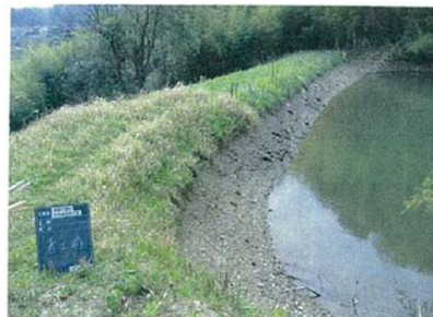
漏水が生じているため池
