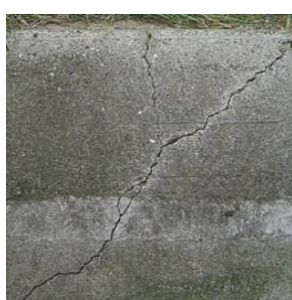
斜め方向のひび割れ
