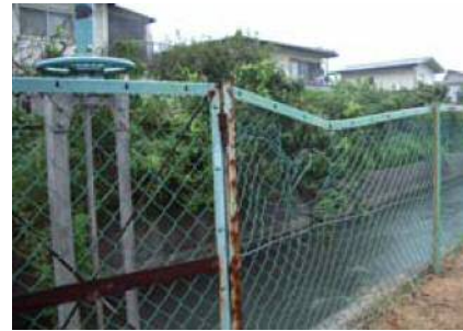
破損した金網フェンス
