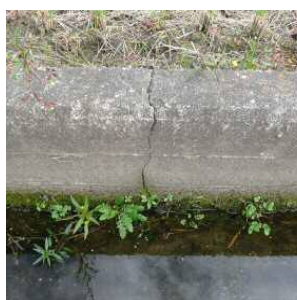
縦方向のひび割れ
